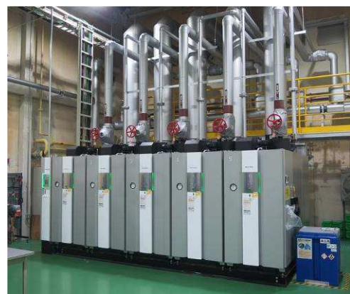
貫流ボイラー
