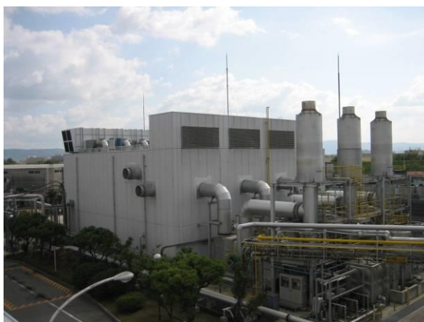
ガスエンジン発電機室と排熱ボイラー
